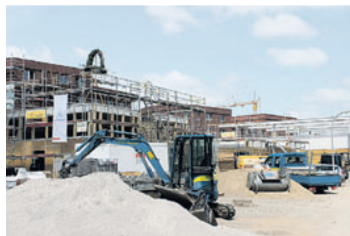
Noch sind hier Flächen frei. Wer Interesse hat, sollte sich umgehend informieren. Foto: ten
