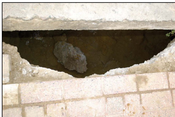
FIG. 12 De kleine opening in het wegdek waaronder de uitspoeling plaats vond.
